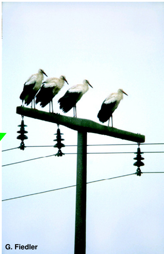
Vogelfreundlicher Mittelspannungsmast mit Hängeisolatoren (links)
