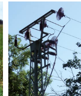
Vogelschutzmaßnahme an Freileitung in Uelzen
