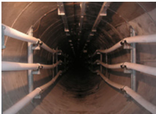
Abb. 2 380-kV-Kabel Berlin-Friedrichshain/Marzahn, Tunnelvariante, Foto: DUH/R. Hänlein
