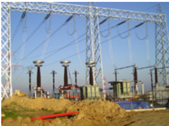
Abb. 3 Übergabestation Erdkabel/Freileitung (400 kV) am Flughafen von Madrid, Foto: Europacable
